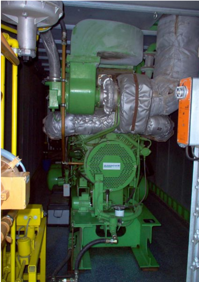
Abb. 2: Mehr als 2.000 PS: Der 600 kW Gasmotor des Deponiegaskraftwerks Gelnhausen-Hailer.
